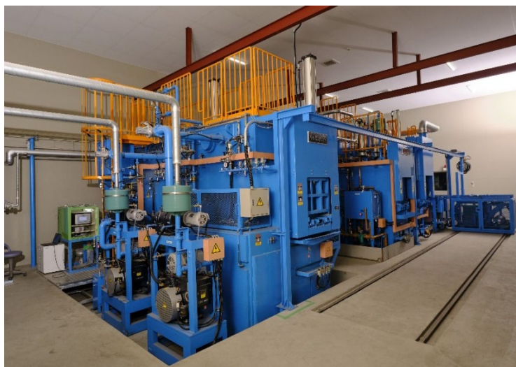
常圧スマート浸炭技術を用いた浸炭炉
