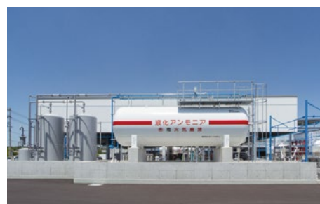
津工場アンモニア設備
