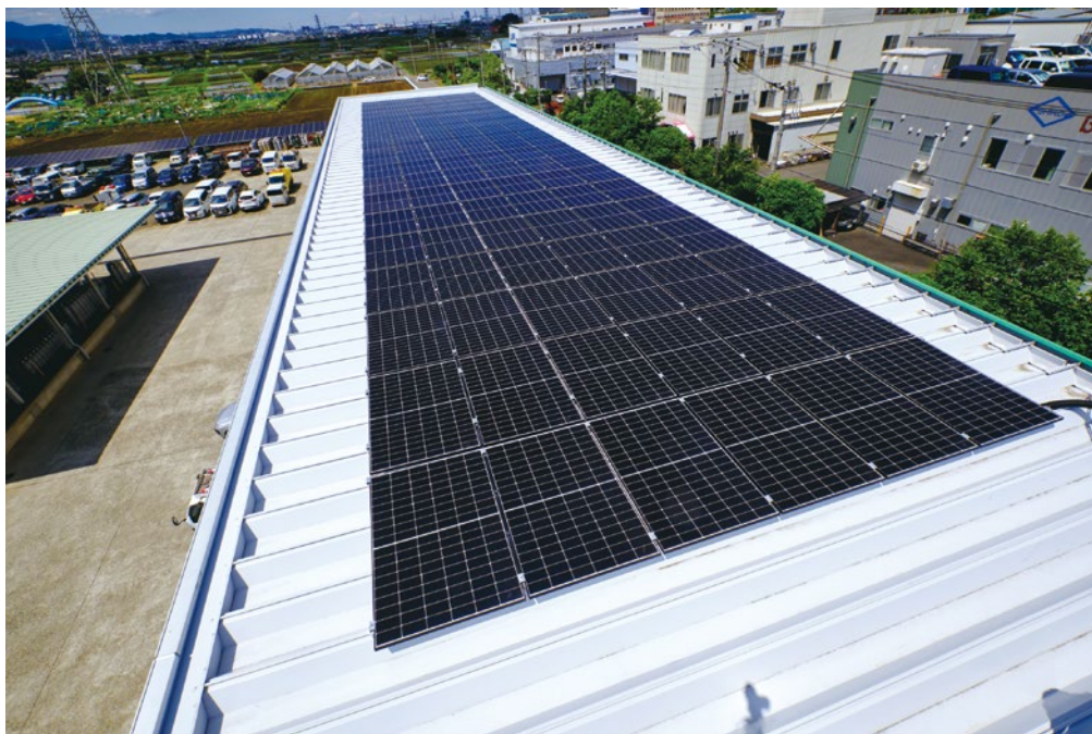
神奈川工場の太陽光発電パネル
