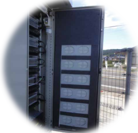
屋外キュービクル
